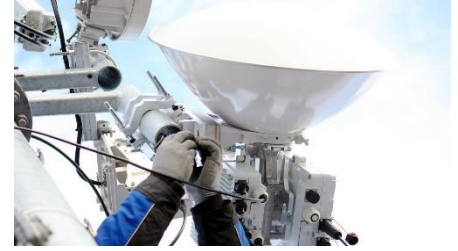
30.01.2019 Telefónica Deutschland baut ersten Dualband-Richtfunk für 5G
